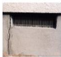
地震による換気口の断裂
