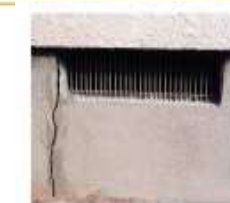
地震による換気口の断裂
