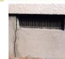
地震による換気口の断裂
