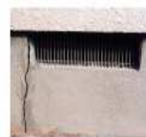
地震による換気口の断裂
